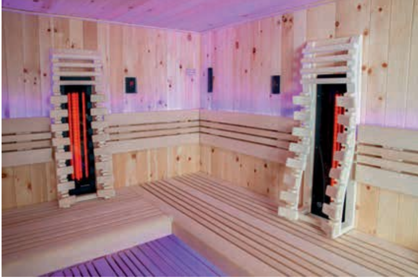
Infrabox kabin içine monte edilmiştir
